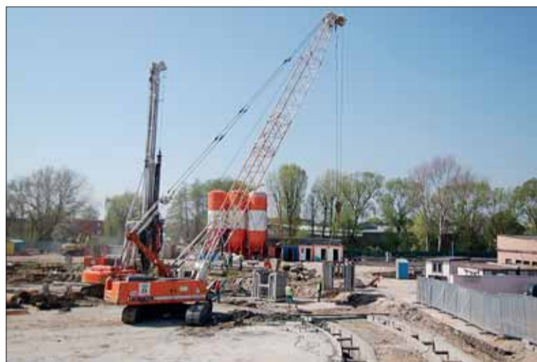
▲ Duben 2011. Na stavbu nastoupily těžké stroje, s jejichž pomocí odborníci vybetonovali dvojkruh sahající do hloubky třiceti metrů. Beton zajistil prostor pro vytěžení jámy a vlastní stavbu.
