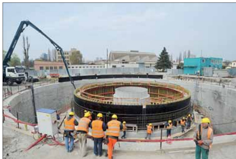
▲ Duben 2012. Rameno dopravníku betonu v akci. Po skončení stavby celou nádrž překryje strop, na který se umístí zemina se zelení. V prostoru nad nádrží bude vysázeno 62 stromů a 2079 keřů. Na povrchu bude viditelný jen malý provozní objekt.
