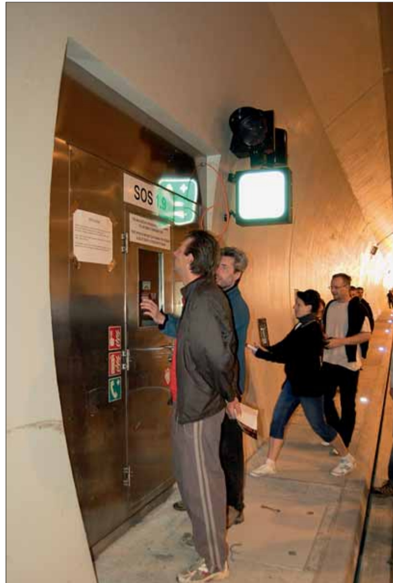
Při červnovém dni otevřených dveří v tunelu si lidé mohli zblízka prohlédnout technologické vybavení včetně SOS skříní. Foto: Z. Gregorová
