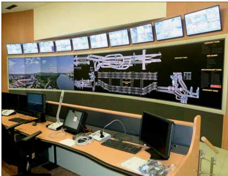
■ Teletěna centrálního technického dispečinku na Renneské třídě. Foto: BKOM
