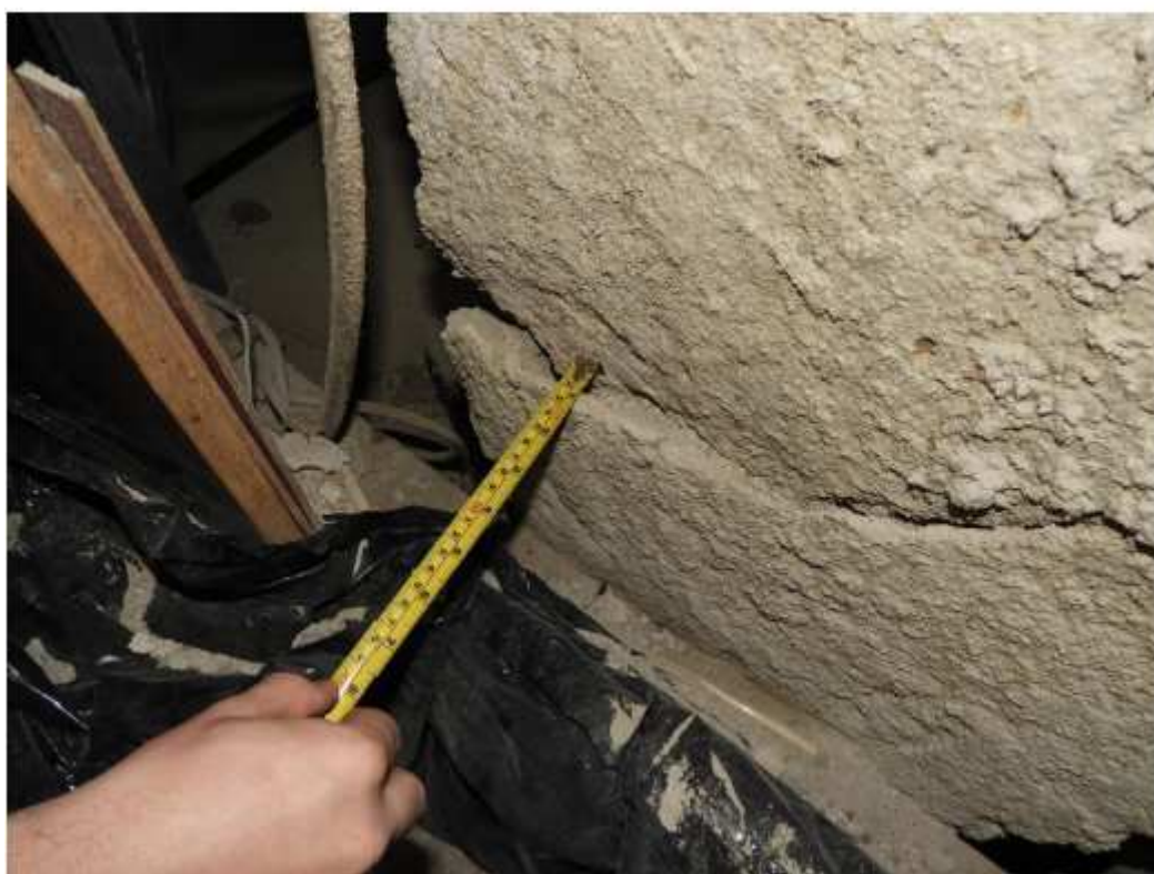
Obr. 9, 10: Sloup Sc6M s výrazným narušením a odtržením krycí vrstvy betonu korodující výztuží v patě sloupu - detaily dokumentující vyklonění odtržené vrstvy betonu
