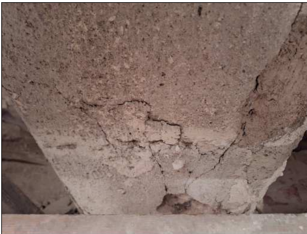
Obr. 5: Sloup Sc5M s výrazným narušením a odtržením krycí vrstvy betonu korodující výztuží
