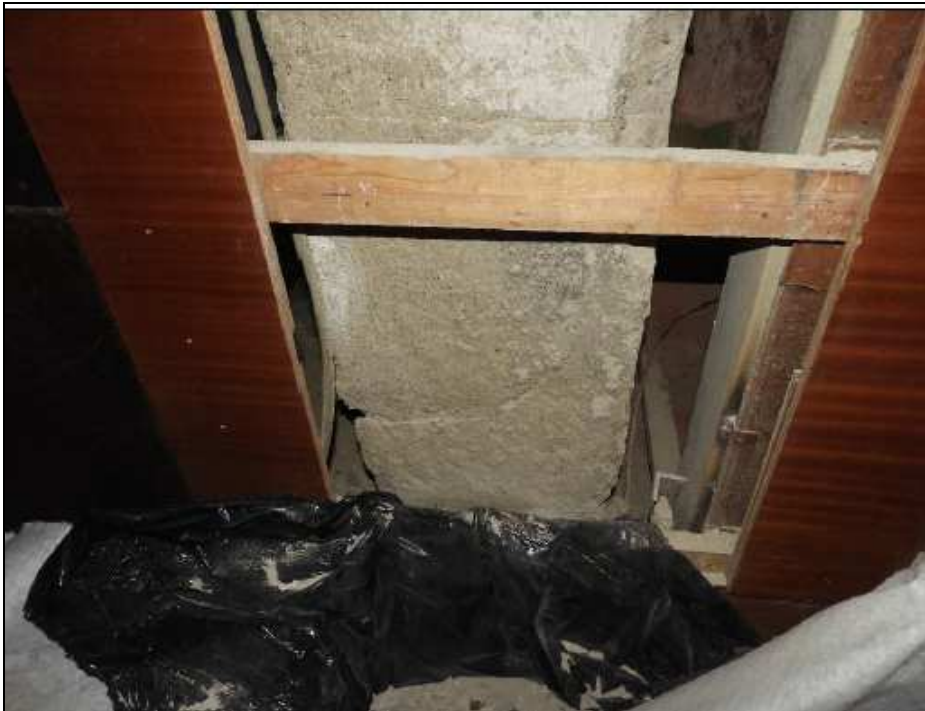
Obr. 8: Sloup Sc6M s výrazným narušením a odtržením krycí vrstvy betonu korodující výztuží v patě sloupu, další trhlina je patrná ve výšce cca 1m
