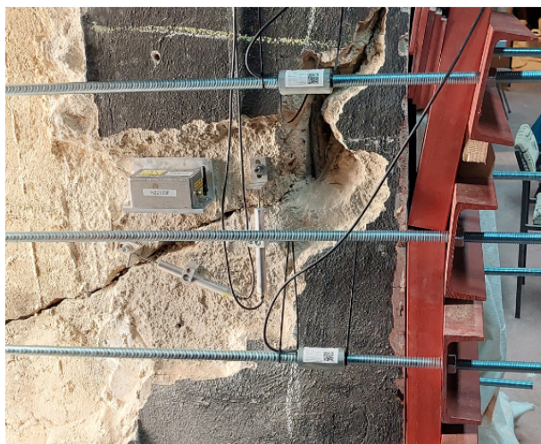
Snímače Dynamag nainstalované na svornících kritického sloupu (2. sloup od jeviště na balkoně vpravo)
