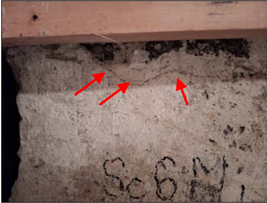
Obr. 13: Sloup Sc6M - vodorovná trhlina ve výšce přes 1m nad podlahou
