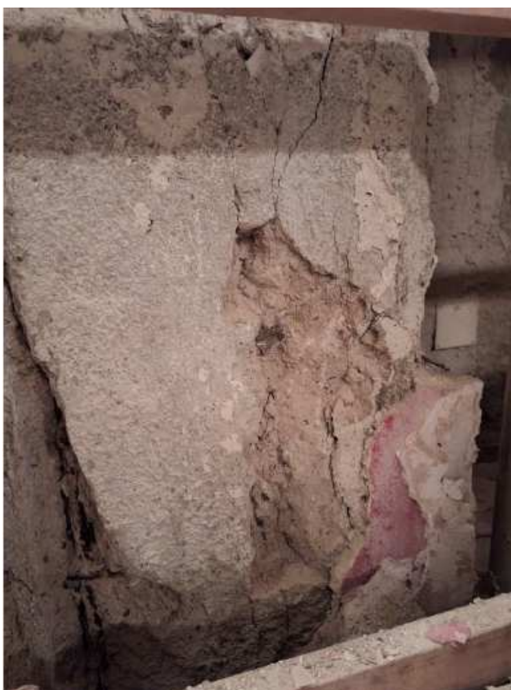
Obr. 6: Sloup Sc5M s výrazným narušením a odtržením krycí vrstvy betonu korodující výztuží
