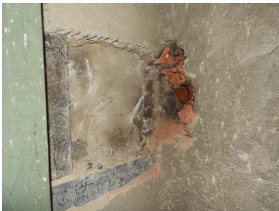
Obr. 3: Sloup Sc4M, mezi ocelovými pláty jsou slabě patrné šikmé trhliny, které byly patrně jedním z důvodů zesílení sloupu
