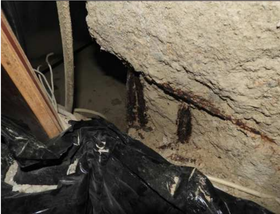
Obr. 11: Sloup Sc6M s výrazným narušením a odtržením krycí vrstvy betonu korodující výztuží v patě sloupu, po odstranění odtržené vrstvy je dobře patrná masivní koroze výztuží
