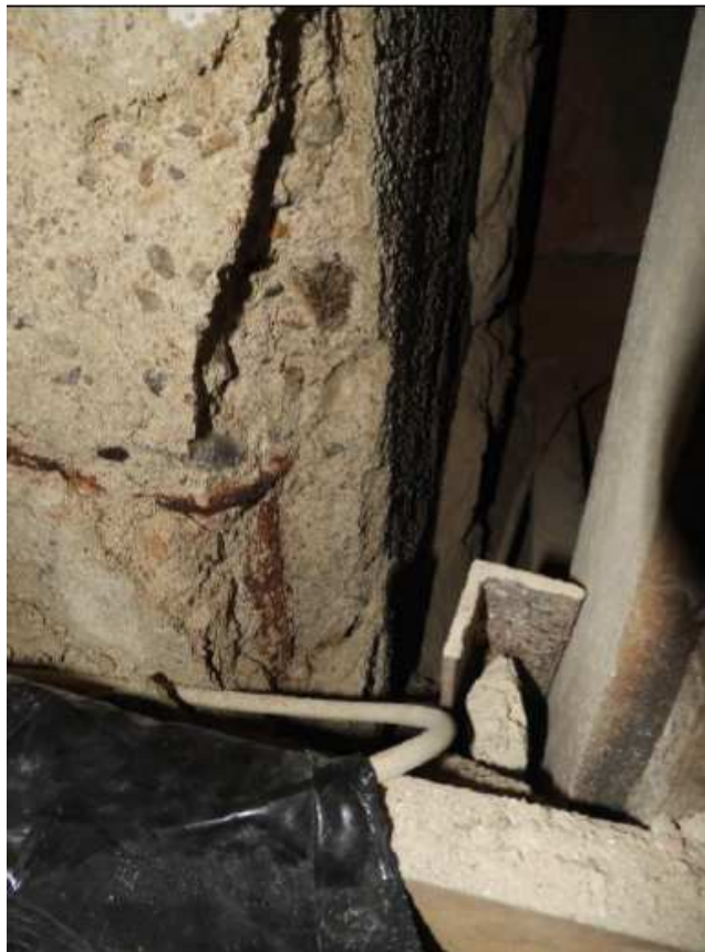
Obr. 12: Sloup Sc6M s výrazným narušením a odtržením krycí vrstvy betonu korodující výztuží v patě sloupu, po odstranění odtržené vrstvy je dobře patrná masivní koroze výztuží
