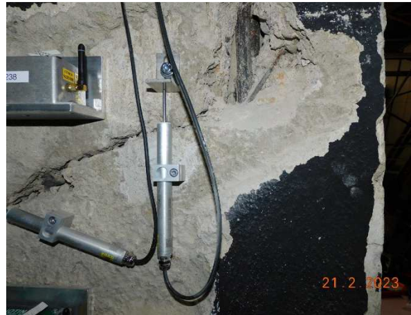
Foto z instalace 21.2.2023, detail snímače DH15
