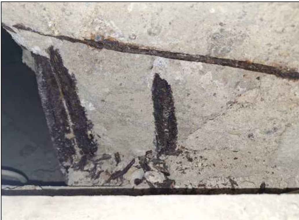
Obr. 14: Sloup SC6M s výrazným narušením a odtržením krycí vrstvy betonu korodující výztuží v patě sloupu, po odstranění odtržené vrstvy je dobře patrná masivní koruze výztuží. Na záběru dvojice výztuží ze základu končí v patě sloupu hákem, a mezi nimi jedna hlavní výztuž sloupu
