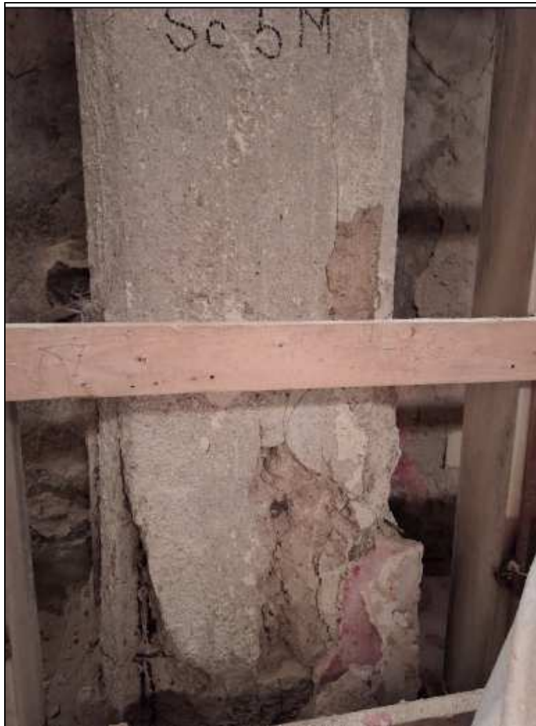
Obr. 4: Sloup Sc5M s výrazným narušením a odtržením krycí vrstvy betonu korodující výztuží
