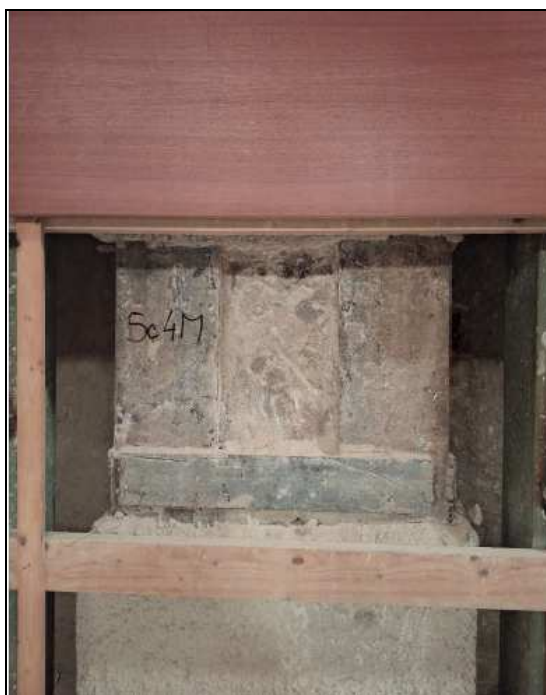
Obr. 2: Sloup Sc4M, kde je v zpřístupněné oblasti patrná ocelová bandáž v podobě úhelníků 200x200 mm tloušťky 30 mm a opásání ocelovými pláty šířky 100 mm a tloušťky 10 mm po obvodu
