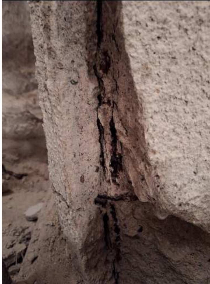
Obr. 7: Sloup Sc5M s výrazným narušením a odtržením krycí vrstvy betonu korodující výztuží, detail u paty sloupu
