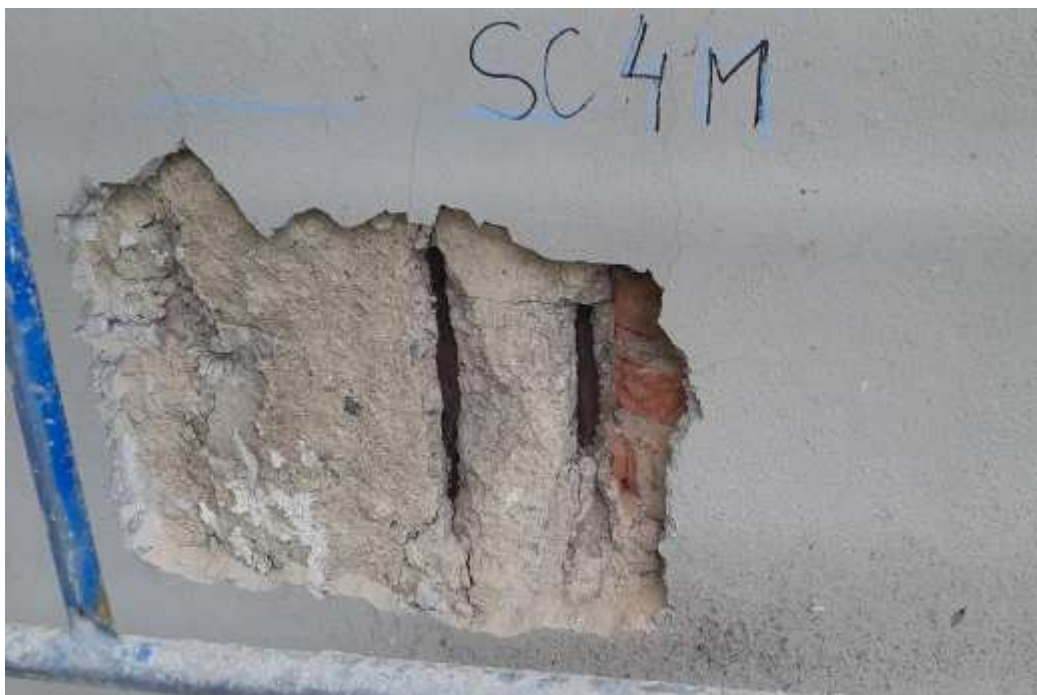
Obr.66: Po odstranění omítky bylo zjištěno odtržení krycí vrstvy betonu a masivní koroze hlavní výztuže sloupu.
