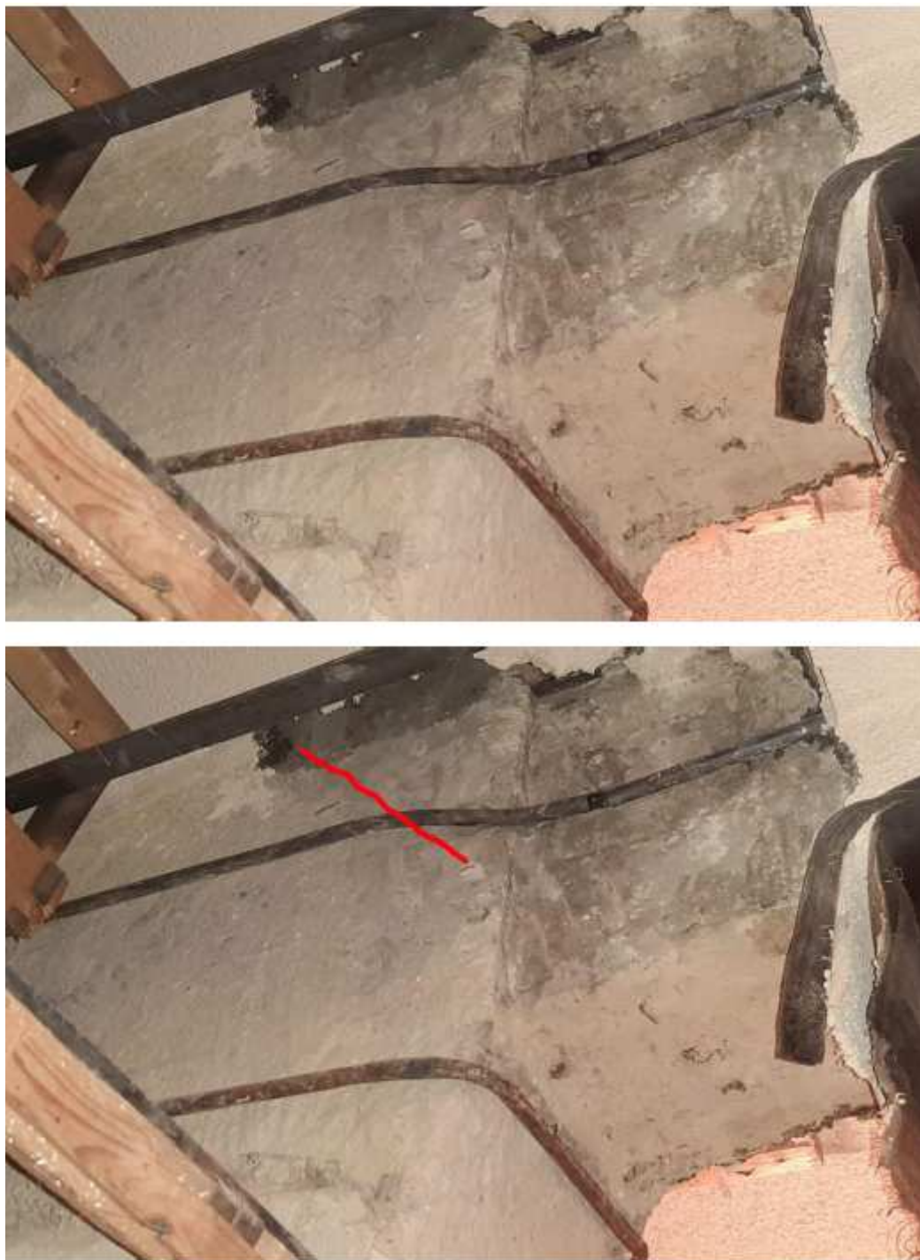
Obr.55-56: Typická trhlina ve sloupu, v místě rámového styčnicku, sonda Sc4J. Na spodním obrázku je pro názornost trhlina zvýrazněna červeně.
