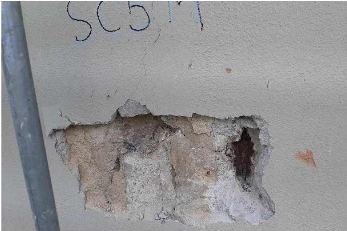
Obr.69: Detail koroze výztuže ve sloupu pod sondou Sc5M
