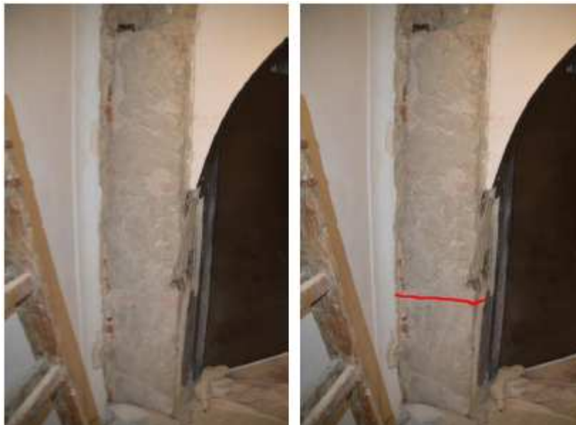
Obr.30-31 : Místo sondy S3J po odstranění části omítky, je patrná vodorovná trhlina ve výšce cca 750 mm nad úrovní podlahy. Pro názornost je v pravém obrázku trhlina zvýrazněna červeně.
