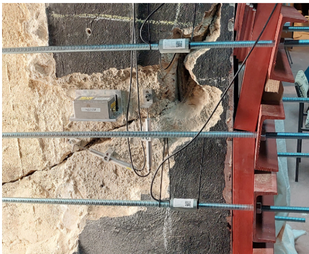
Snímače Dynamag nainstalované na svornících kritického sloupu (2. sloup od jeviště na balkoně vpravo)
