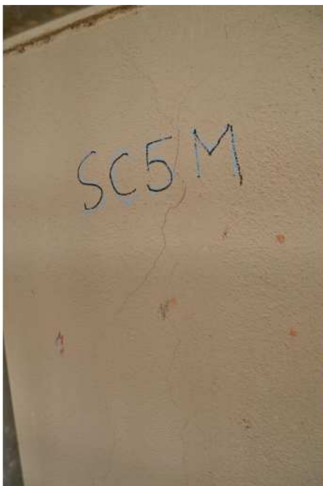
Obr.68: Pod sondou Sc5M v exteriéru objektu, v úrovni cca 1 m nad úrovní terénu ve dvorním traktu byly na novější fasádě patrné stejné projevy koroze výztuže, což potvrdila sekaná sonda
