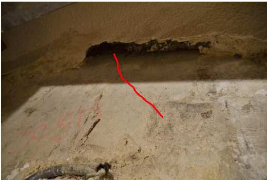
Obr.59-60: Typická trhlina ve sloupu, v místě rámového styčnicku, sonda Sc5M. Na spodním obrázku je pro názornost trhlina zvýrazněna červeně.
