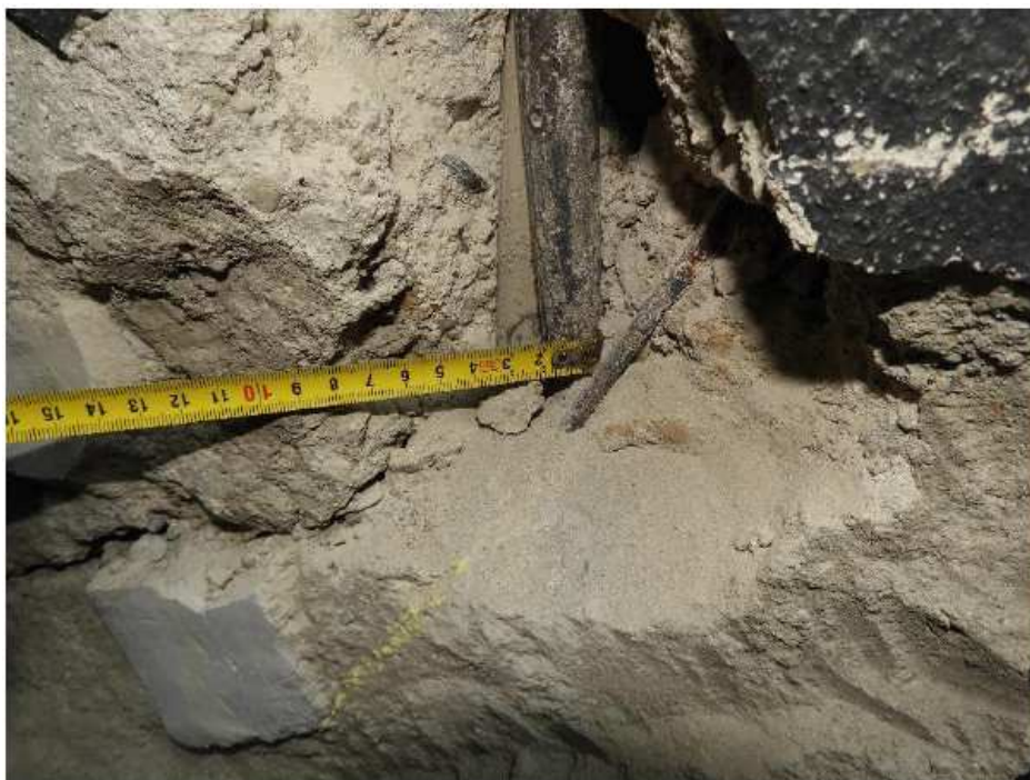
Obr.10 : Detail vytržené výztuže z původní polohy v sondě S5M, původní otisk v cementové matici dobře patrný.
