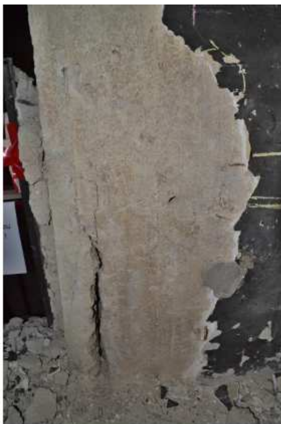
Obr.49 : Místo sondy S6M, po odstranění omítky se jasně ukázalo, že jedna z trhlín kopírovala odtržení čelní strany betonu i s výztuží (boulení, mimo jiné v důsledku absence třmínek).
