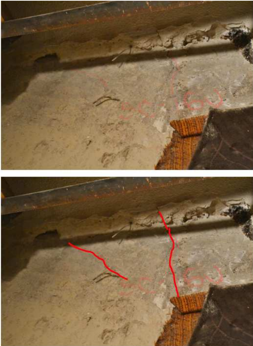
Obr.61-62: Typická trhлина ve sloupu, v místě rámového styčnicku, sonda Sc6J. Na spodním obrázku je pro názornost trhлина zvýrazněna červeně.
