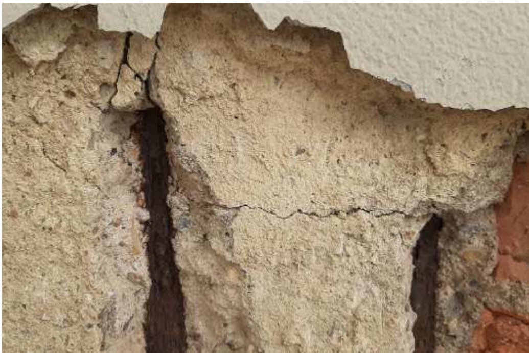
Obr.67: Detail korodované výztuže z předchozího obrázku.
