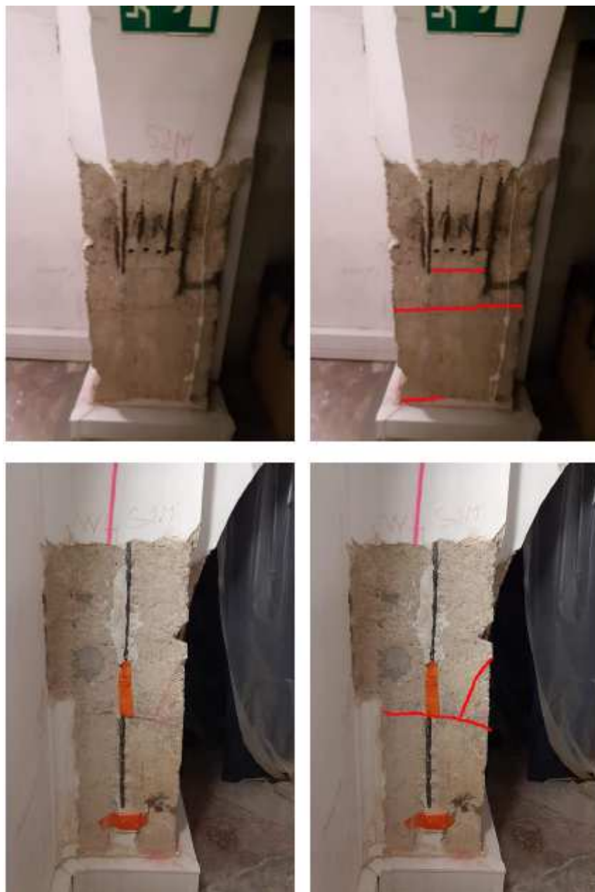
Obr.26-29 : Místo sondy S2M po odstranění části omítky, na bočním líci je patrná vodorovná trhlinka ve výšce cca 870 mm nad úrovní podlahy, na čelním trhliny ve výšce 170 a 890 mm nad podlahou a výše pracovní spára. Pro názornost jsou v pravých obrázcích trhliny zvýrazněny červeně.
