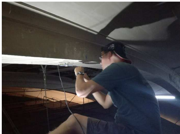
Instalace snímače DH15 ve stropním vazníku
