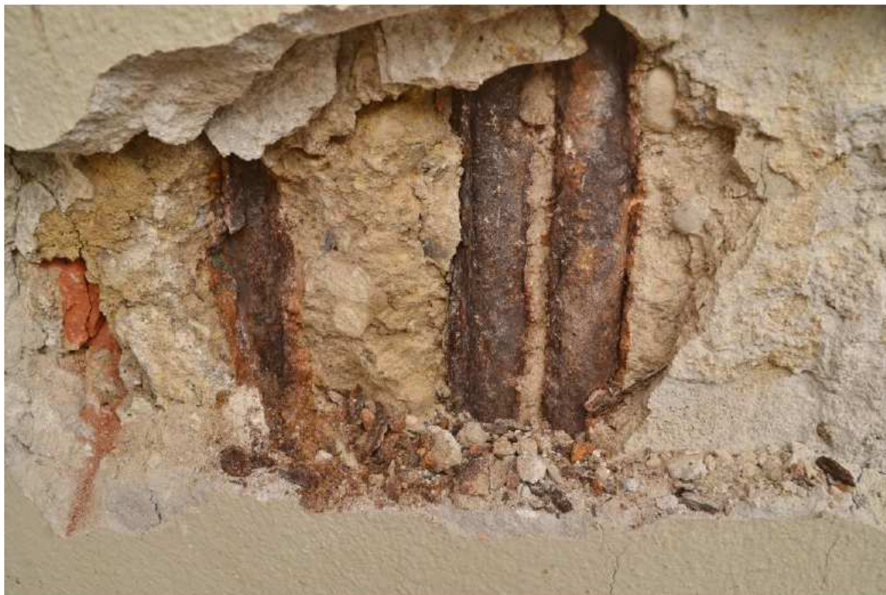
Obr.71: Detail koroze výztuže ve sloupu pod sondou Sc6M, v úrovni cca 1 m nad terénem dvorku.
