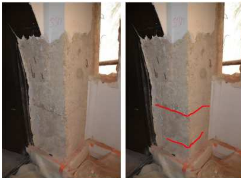
Obr.32-33 : Místo sondy S3M po odstranění části omítky, jsou patrné vodorovné trhliny ve výšce cca 420 a 830 mm nad úrovní podlahy. Pro názornost jsou v pravém obrázku trhliny zvýrazněny červeně.
