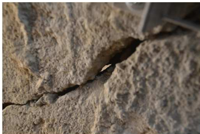
Obr.12-16 : Odstranění omítky v místě trhlin na sloupu S5M ukázalo jasnou existenci masivní trhliny, prakticky zcela od sebe oddělující beton sloupu nad a pod trhlinou se vzájemným vodorovným posunem jednotlivých segmentů
