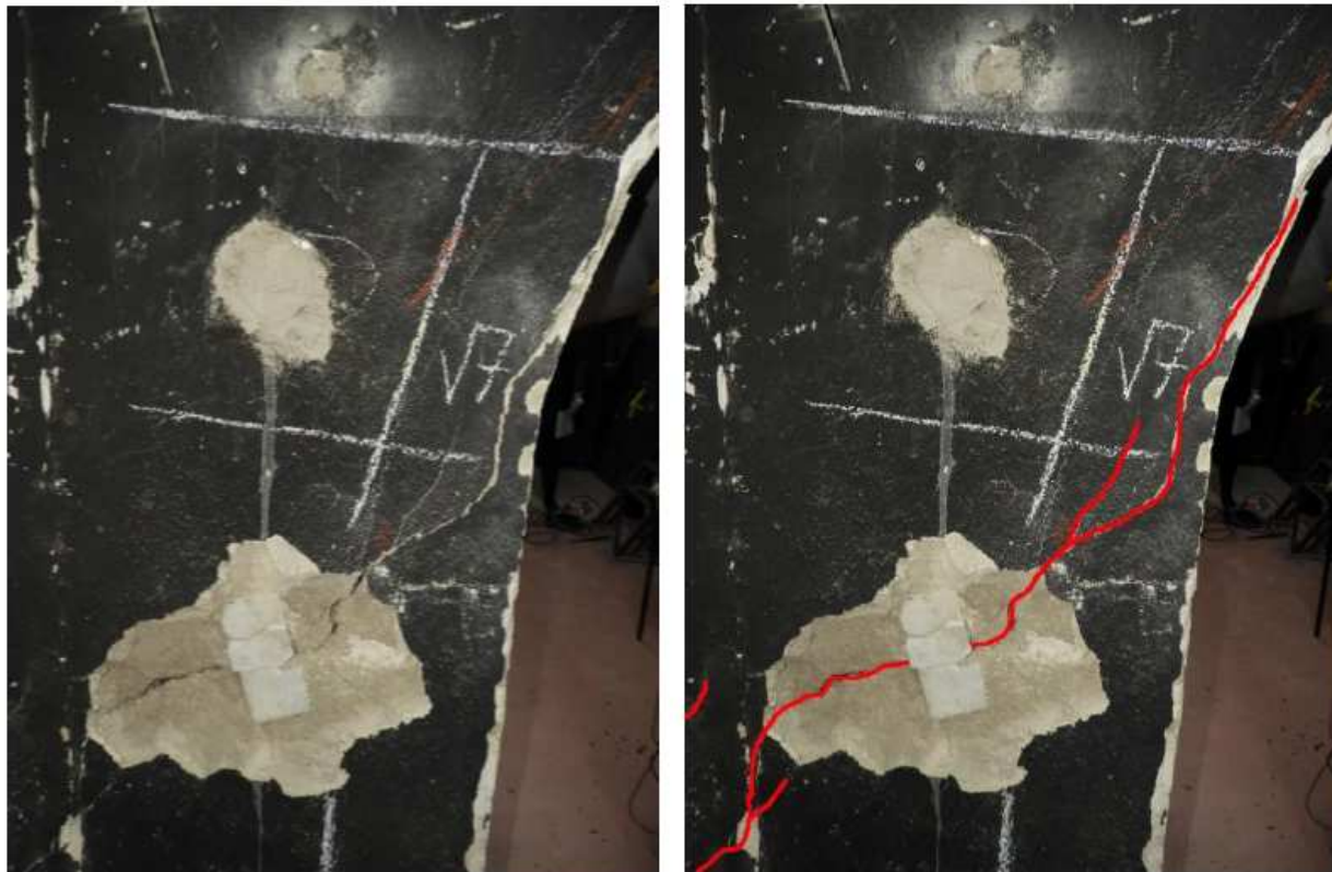
Obr.8 : Místo sondy S5M po odstranění části omítky v místě trhliny na boku sloupu, pod omítkou byla zachována sádrová destička neznámého stáří pro sledování trhliny. Je patrné její roztržení, a vodorovný posun v trhlíně. Pro názornost jsou v pravém obrázku trhliny zvýrazněny červeně.
