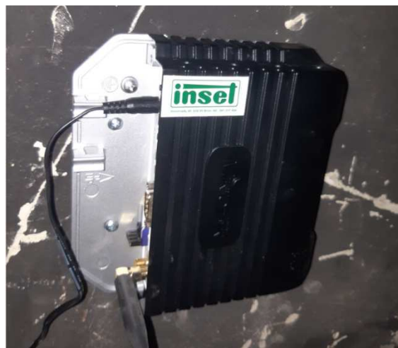
Foto z instalace 21.2.2023, router – přijímá data ze snímačů IOT a odesílá data přes datovou síť od systému Miner
