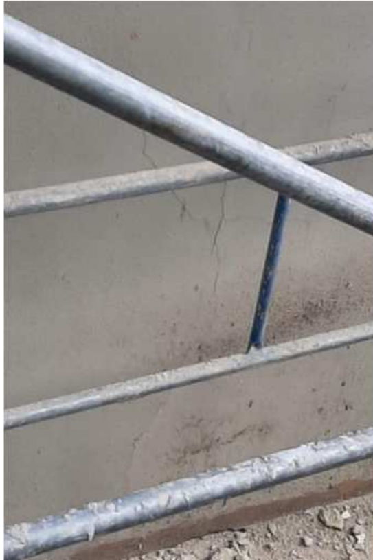
Obr.65: Pod sondou Sc4M v exteriéru objektu, v úrovni cca 1 m nad úrovní terénu ve dvorním traktu byly na novější fasádě patrné trhliny, a boulení omítky.
