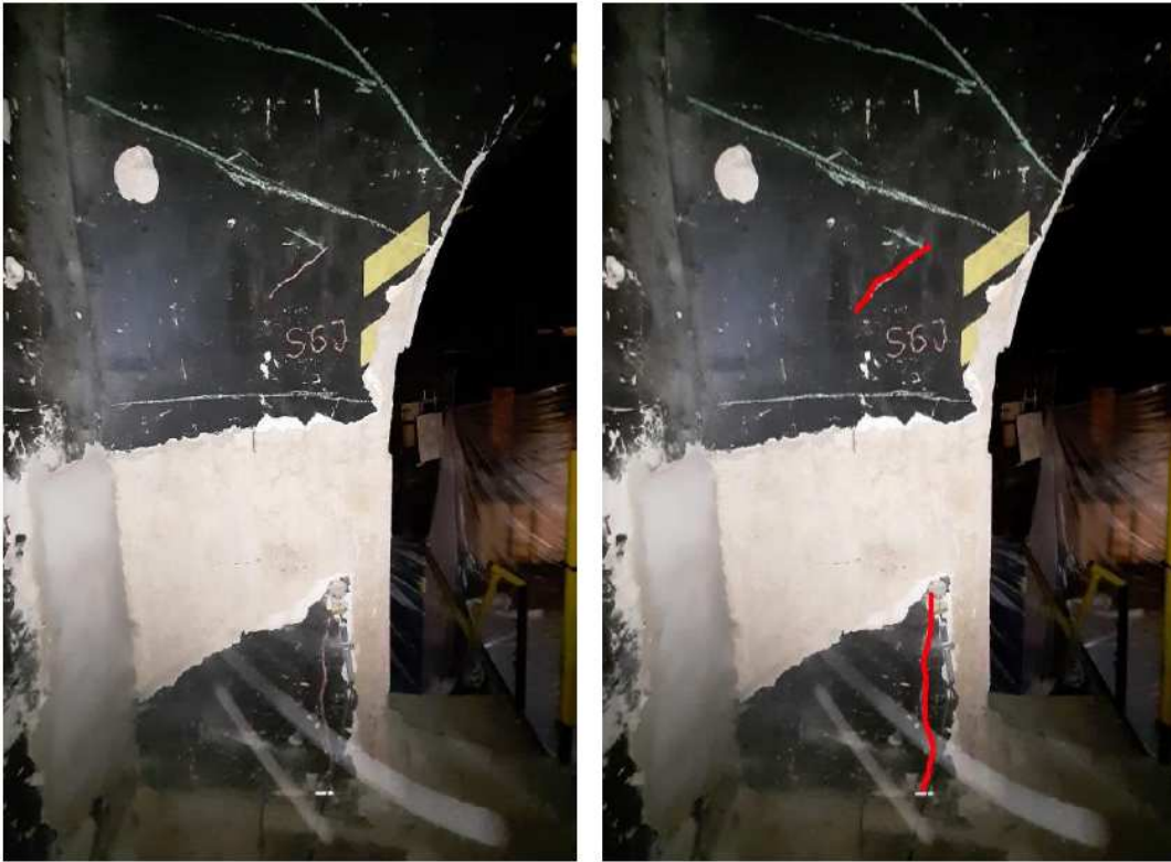
Obr.41-42 : Místo sondy S6J po odstranění části omítky, je patrné především odtržené čelo sloupu do výšky cca 500 mm. Pro názornost jsou v pravém obrázku trhliny zvýrazněny červeně.
