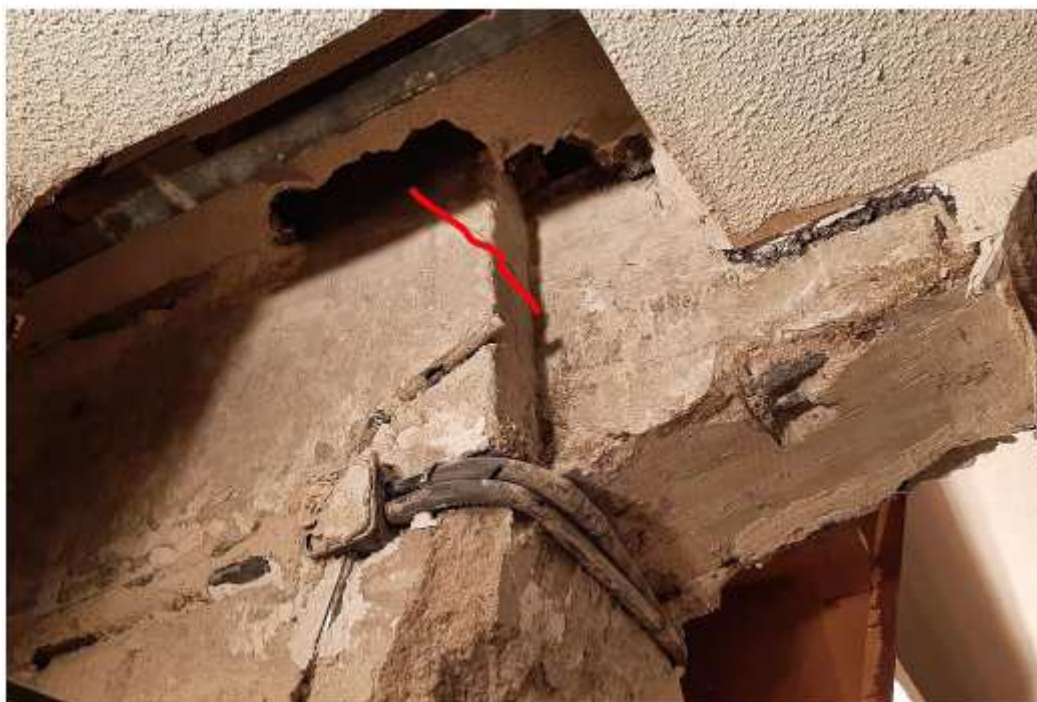
Obr.53-54: Typická trhлина ve sloupu, v místě rámového styčnicku, sonda Sc3M. Na spodním obrázku je pro názornost trhлина zvýrazněna červeně.
