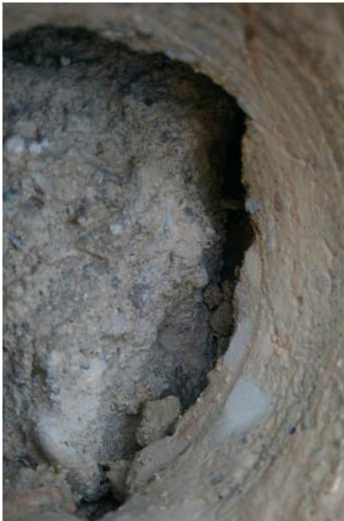
Obr.50 : Místo sondy S6J v místě jádrového vrtání z exteriéru budovy. I zde došlo k odtržení povrchové vrstvy betonu boulením výztuže, stejně jako na straně v interiéru!
