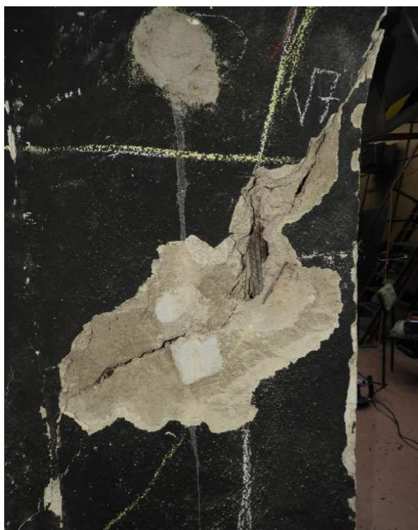
Obr.9 : Po odstranění části uvolněného betonu v trhlíně v sondě S5M byla zjištěna hlavní výztuž z oblouku, vytržená z původní polohy.
