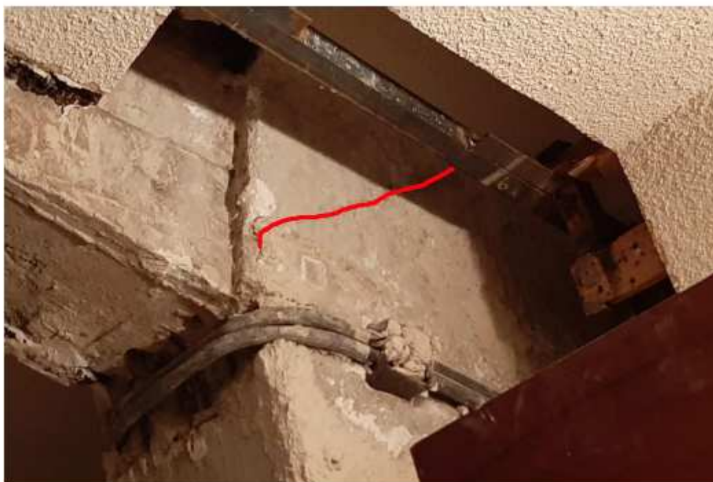
Obr.57-58: Typická trhлина ve sloupu, v místě rámového styčnicku, sonda Sc4M. Na spodním obrázku je pro názornost trhлина zvýrazněna červeně.
