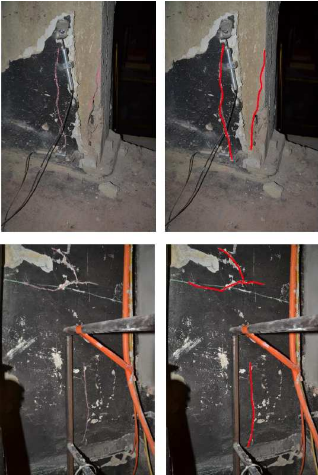
Obr.43-46 : Místo sondy S6J, detail odtrženého čela sloupu a trhliny na protilehlé straně sloupu. Pro názornost jsou v pravém obrázku trhliny zvýrazněny červeně.
