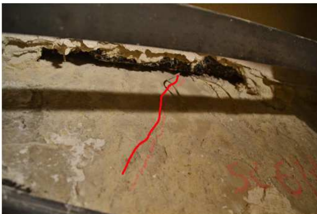
Obr.63-64: Typická trhлина ve sloupu, v místě rámového styčnicku, sonda Sc6M. Na spodním obrázku je pro názornost trhлина zvýrazněna červeně.
