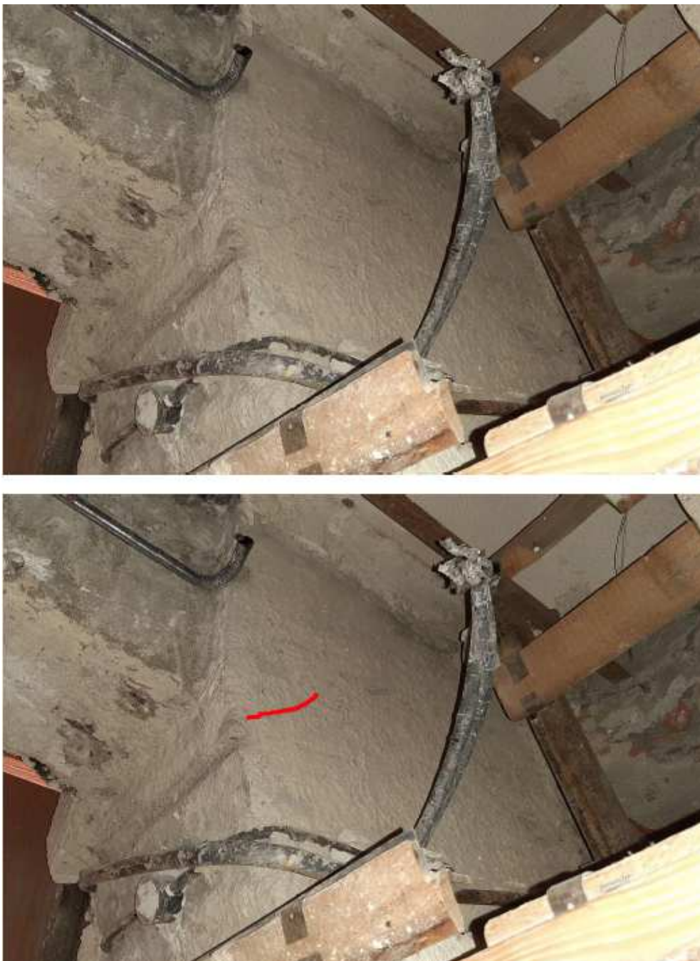
Obr.51-52: Typická trhlina ve sloupu, v místě rámového styčnicku, sonda Sc3J. Na spodním obrázku je pro názornost trhlina zvýrazněna červeně.
