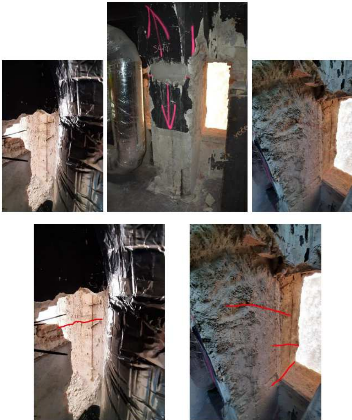
Obr.36-40 : Místo sondy S4M po odstranění části omítky, jsou patrné šikmé a vodorovné trhliny. Pro názornost jsou v dolních obrázcích obrázku trhliny zvýrazněny červeně.
