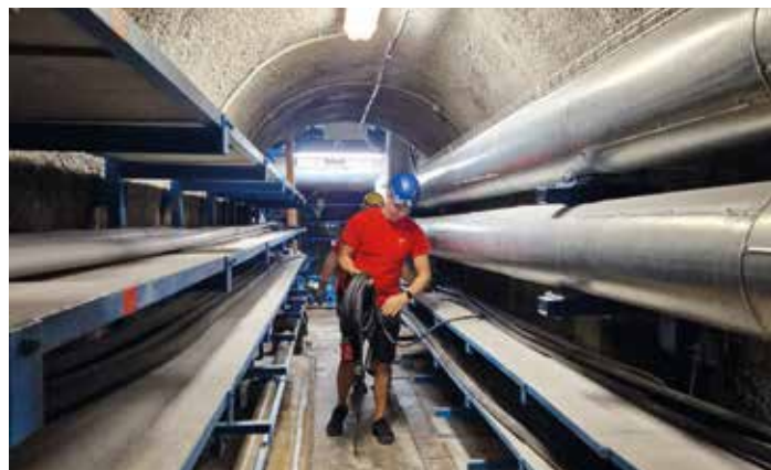
Opravy nebo údržba sítí probíhají v kolektoru mnohem jednodušeji. Foto: Zdeňka Obalilová
